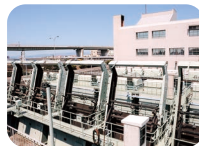
忠岡雨水ポンプ場
