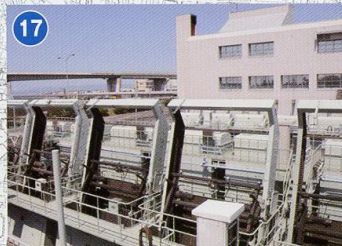
● 雨水ポンプ場 〒595-0811 忠岡北3-10-17
